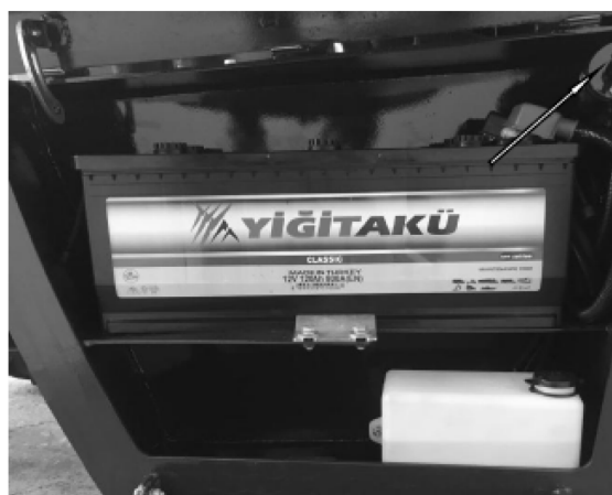
Рисунок 3.60 Главный выключатель аккумуляторной батареи
